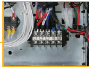
Dış ünite güç besleme terminal bloğu
